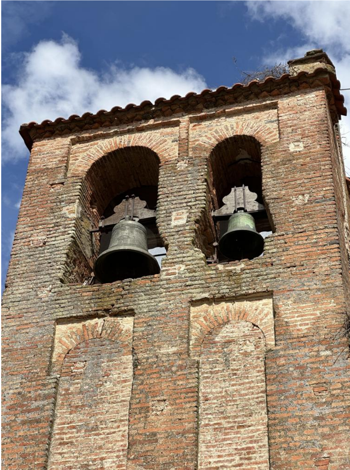
Torre cuadrangular, situada de manera poco habitual en la zona de cabecera del edificio.
